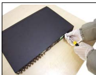
① 拆卸主机上盖的固定螺丝
